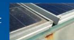
長期使用時の折板屋根部のサビ被害写真
